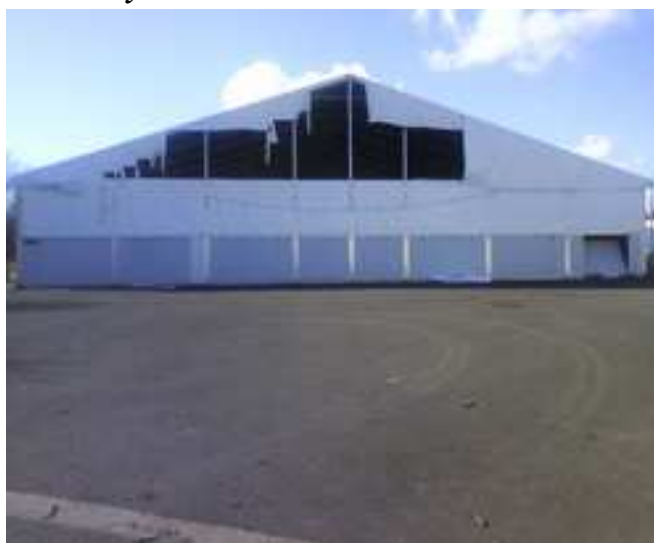
Structure de Noron impactée par Xynthia (2010)
